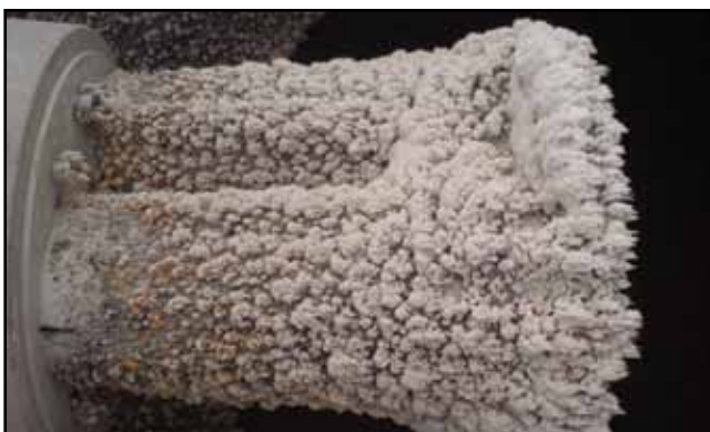
Unidad exterior está recubierta con acumulación de polvo.
