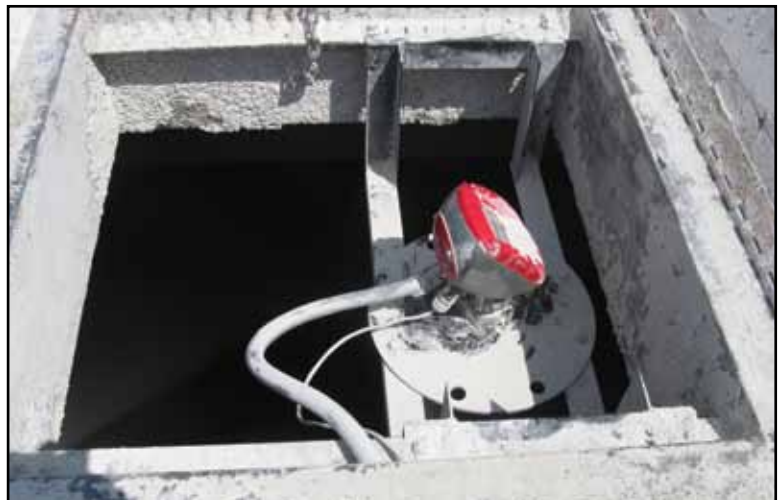
Una aplicación de polvo en una planta de etanol.
